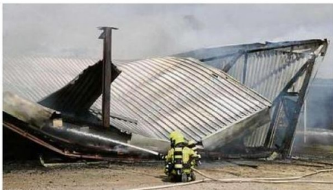
Das Gebäude aus Stahlträgern und Holzbalken stürzte noch während der Löscharbeiten in sich zusammen.
